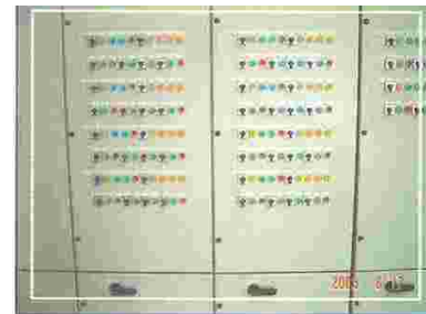
لوحات تشغيل الضواغط المركزية
