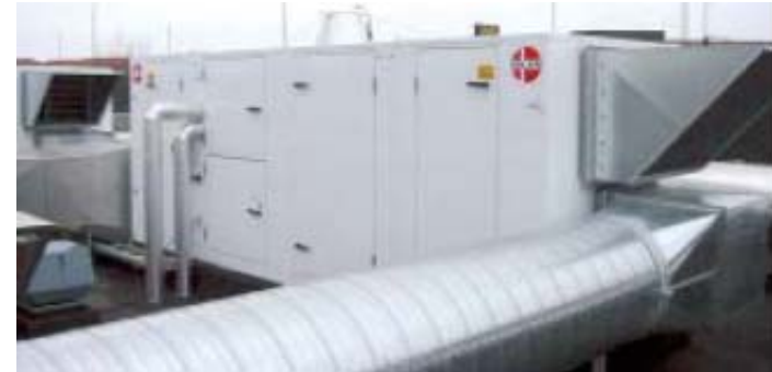
Wärmerückgewinnung mit CO 2 -Wärmepumpe bei McDonald's in Vejle, DK
