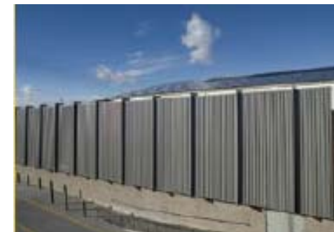
Solare Vorwärmung der Zuluft bei Wal-Mart in Colorado
